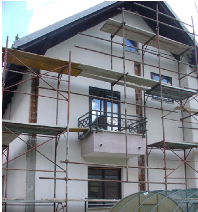
Utrjevanje stavbe z vertikalnimi zidnimi vezmi s kasnejšim povezovanjem s horizontalnimi jeklenimi zidnimi vezmi
